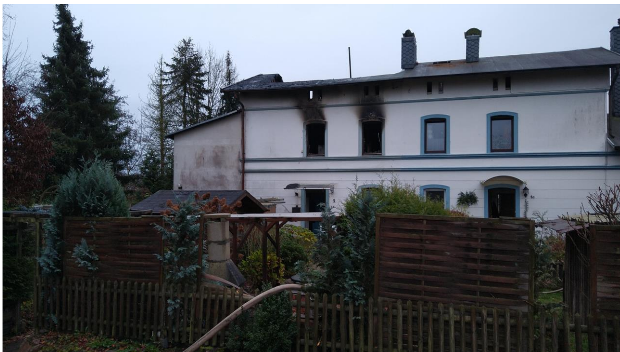
Das einsturzgefährdete Gebäude am Morgen nach dem Brandereignis
